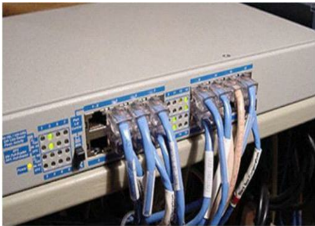
Figura 8.52 – Switch com vários cabos ligados a ele.
